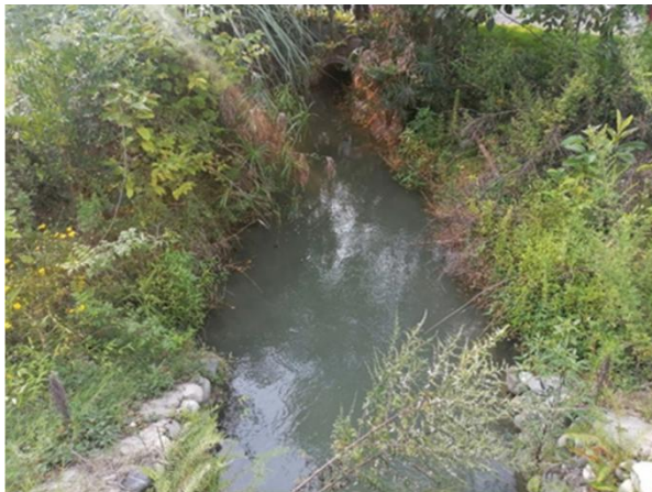
南五支渠现状渠道未硬化，渗漏
