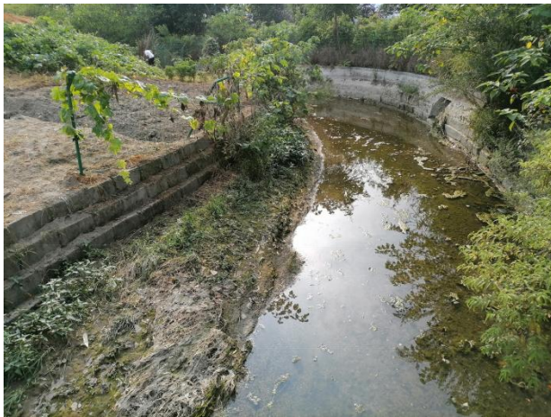
渠道淤积，渠底渗漏，岸坡滑坡
