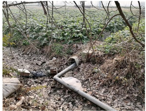
渠道破损，分水口缺乏控制性工程
