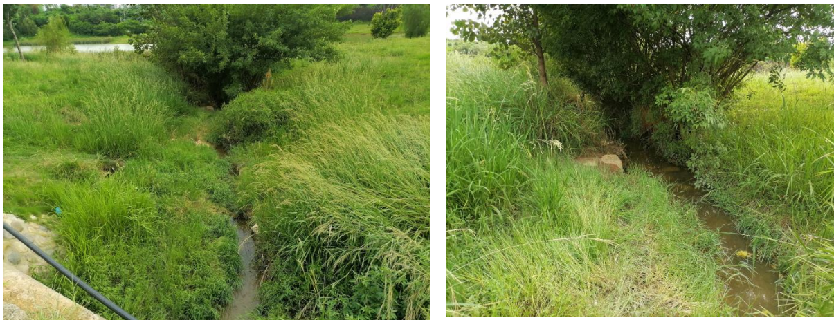
渠道淤积，补水能力不足
