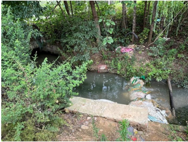
南六支渠取水点缺乏控制性工程
